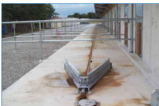
Faltschieber in Sonderausführung im Paddock
