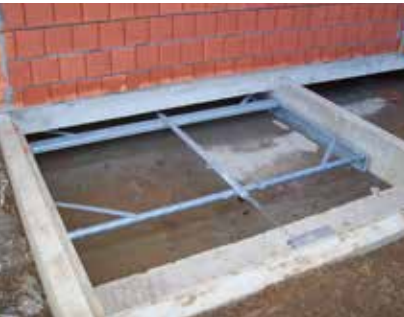
Unterflurschieber, verzinkt, im Schweinestall
