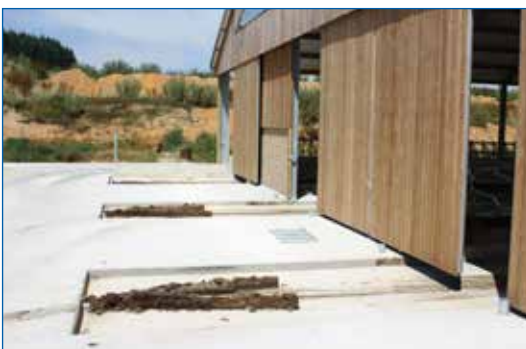
Faltschieber in Parkstellung vor dem Stall
