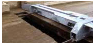
Umschalten der Räumklappen nach unten
