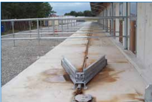
Faltschieber in Sonderausführung im Paddock
