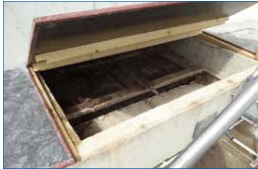
Unterflurschieber über Abwurf - Pig Port
